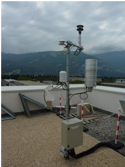
Figure 9 : mât, capteurs, coffret 1 et gaines
